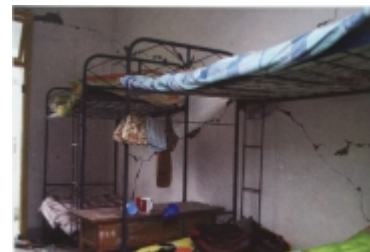
Fig7. – Damage of A5
