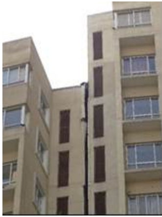
Fig. 12 – Expansion joint damage (KA)
